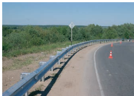
Одностороннее барьерное ограждение
