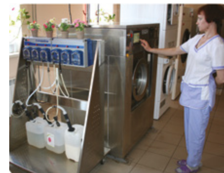
Оборудование «Вязьма» в прачечной
